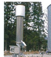
消化ガス燃焼装置
