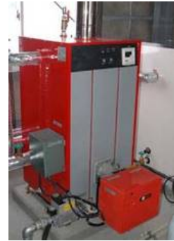
バイオガス温水ボイラ
