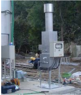
バイオガス燃焼処理装置
