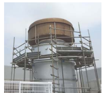
排気処理燃焼炉
