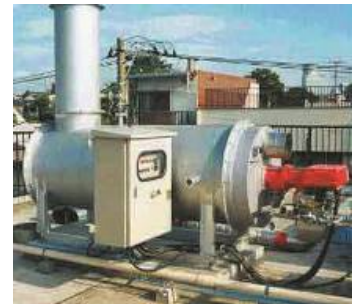
排ガス燃焼処理装置
