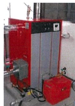
バイオガス温水ボイラ
