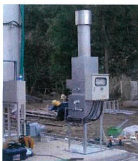
バイオガス燃焼処理装置
